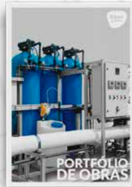
TRATAMENTO DE ÁGUA POTÁVEL
