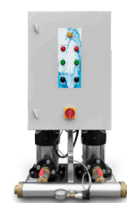
CENTRAL DE PRESSURIZAÇÃO | VX 15-3 E VX 10-4
